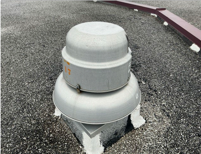
25 - ROOFTOP EXHAUST FAN
